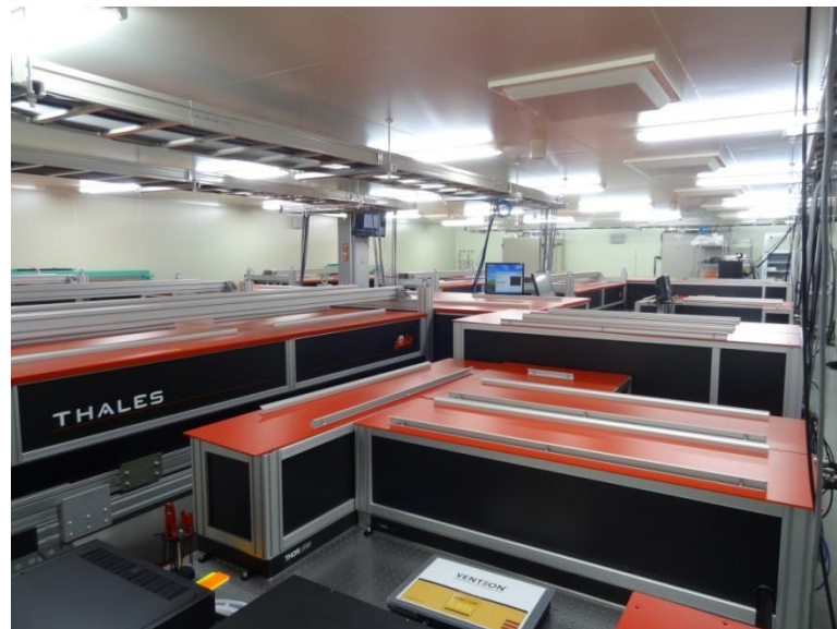
インストール中のPWレーザー
